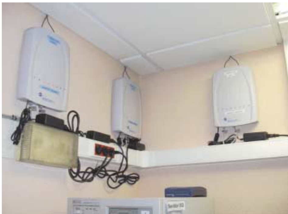
GSM Routers de la central de Valladolid.
