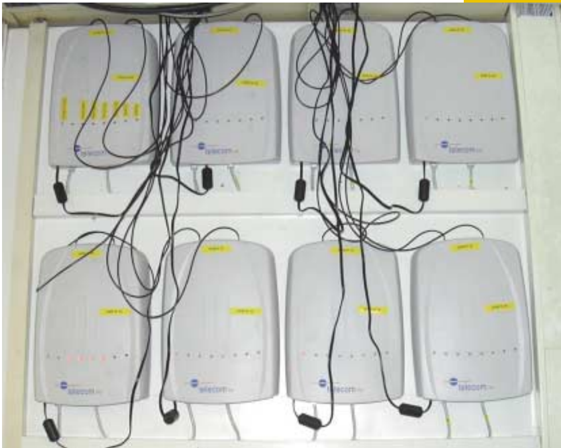
GSM Routers de la central de Madrid
